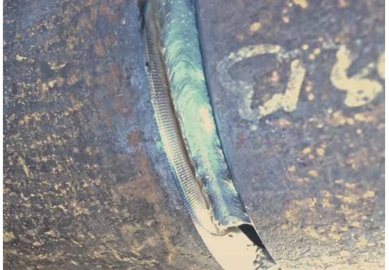
IAC – juurihitsin hitsaus pystysuoraan alaspäin kaukolämpöputkessa. Hitsaus on merkittävästi nopeampaa verrattuna perinteiseen ylöspäin tapahtuvaan hitsaukseen.
